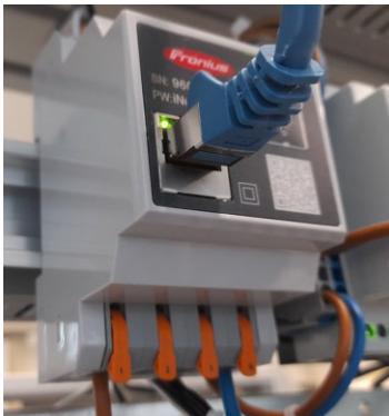
Abbildung 91: 3-Phasen-Stromzähler zu Wechselrichter, über Wandler-Messung, Fronius (Einbindung über Modbus TCP):
