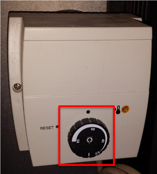
Bild link: Beispiel eines Boiler-Thermostats mit Temperatureinstellung. Hier wurde der Sollwert auf 60°C eingestellt (rot eingerahmt).
